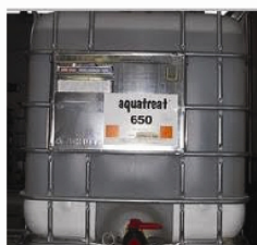
Hóa chất cho nồi hơi Chemicals for boilers
